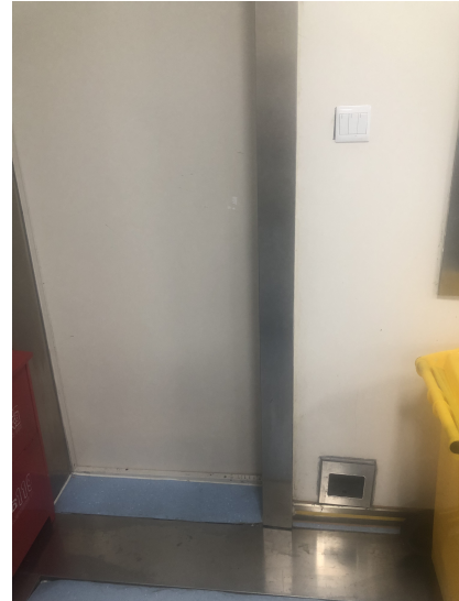
图 3-6 介入室（一）机房门闭门装置
