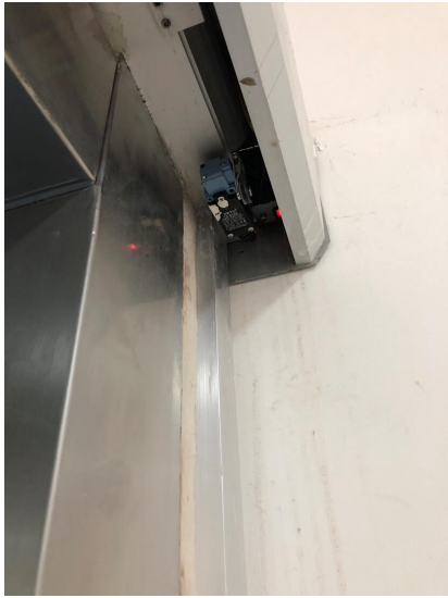
图 3-3 介入室（一）DSA 机房门感应装置
