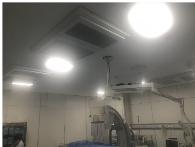
图 3-7 介入室（一）排风系统
